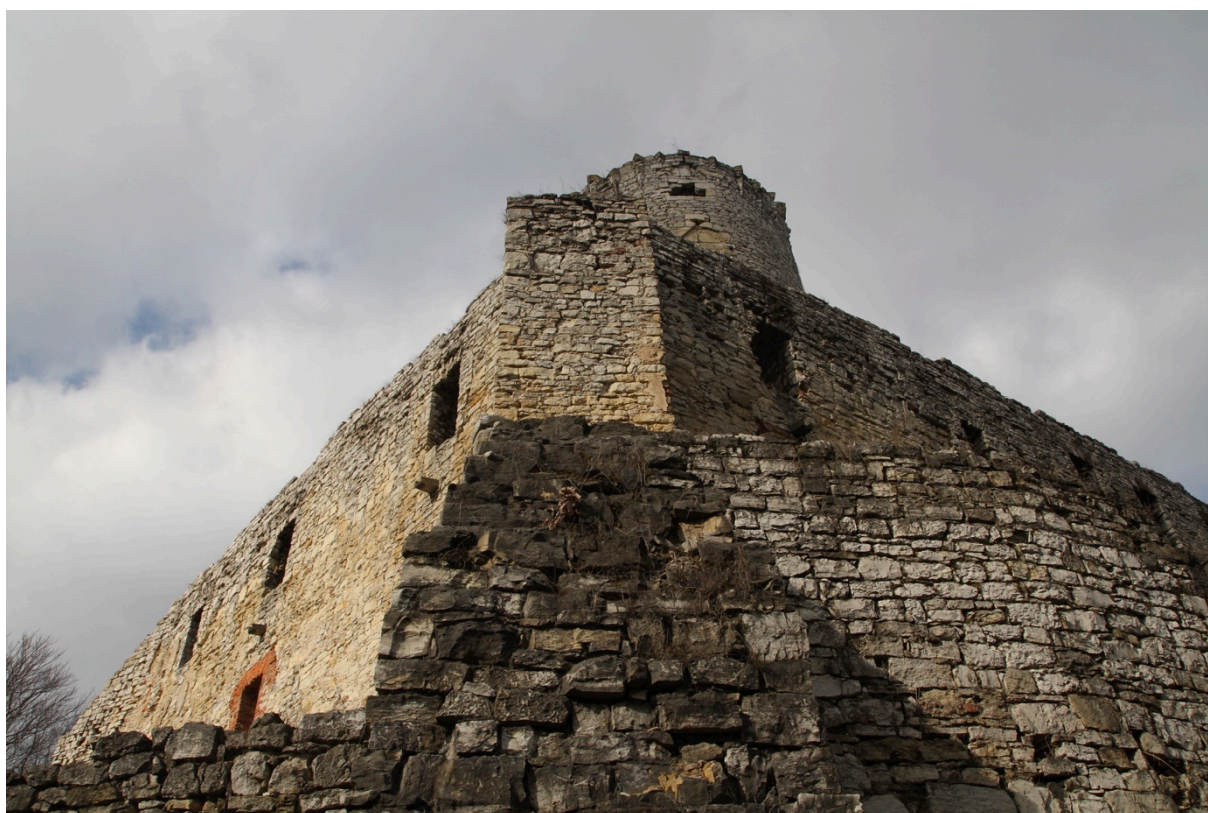
Fot.2. Zamek Lipowiec, widoczna zniszczona szkarpa murów obronnych.
