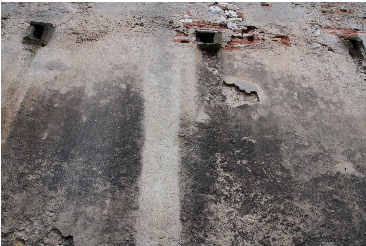
Fot.9. Zamek Lipowiec. Stan zachowania tynków na elewacji zamku.
