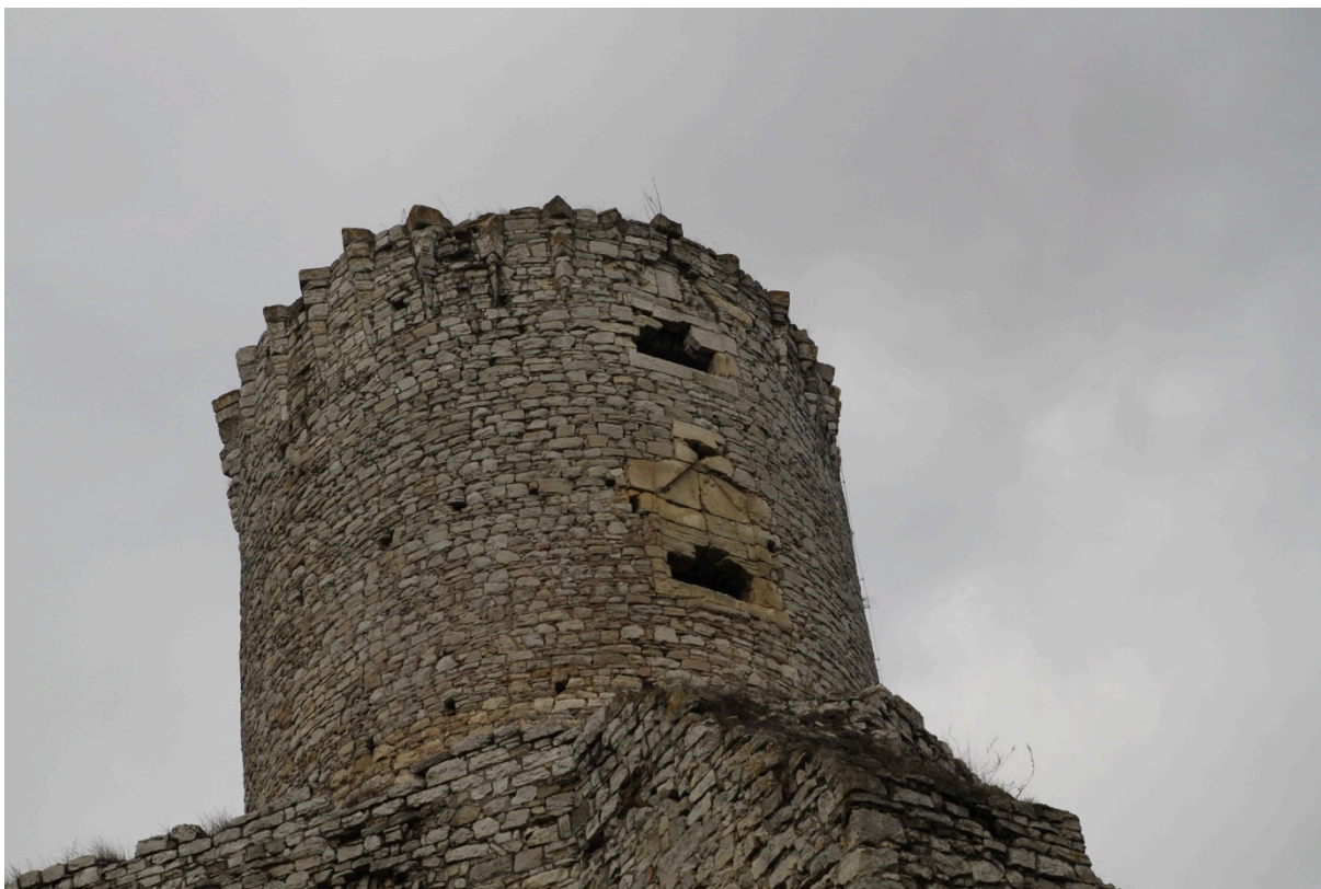
Fot.3. Zamek Lipowiec, wieża z działobitniami. W górnej części widoczne duże ubytki wsporników podtrzymujących niegdyś trzecia kondygnacje wieży.
