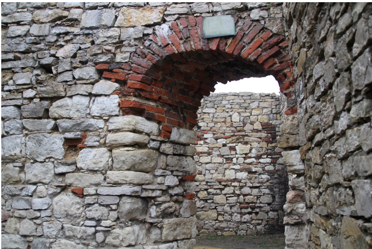
Fot.36. Zamek w Lipowcu, II piętro. Stan zachowania wątków kamiennych i ceglanych.
