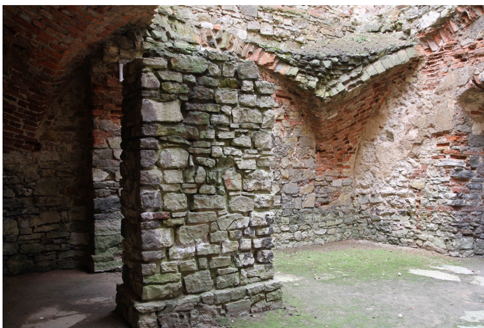
il.26. Skarbiec, widoczny stan zachowania wążków oraz silne skażenie biologiczne.
