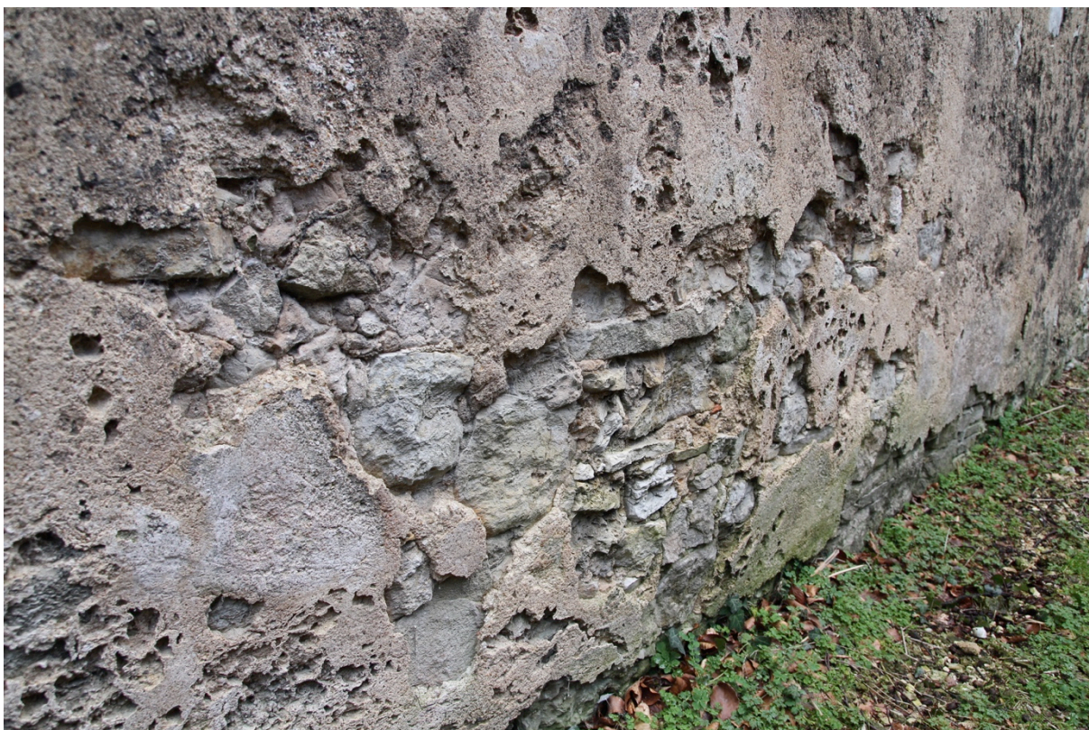
Fot.10. Zamek Lipowiec. Stan zachowania tynków na elewacji zamku.
