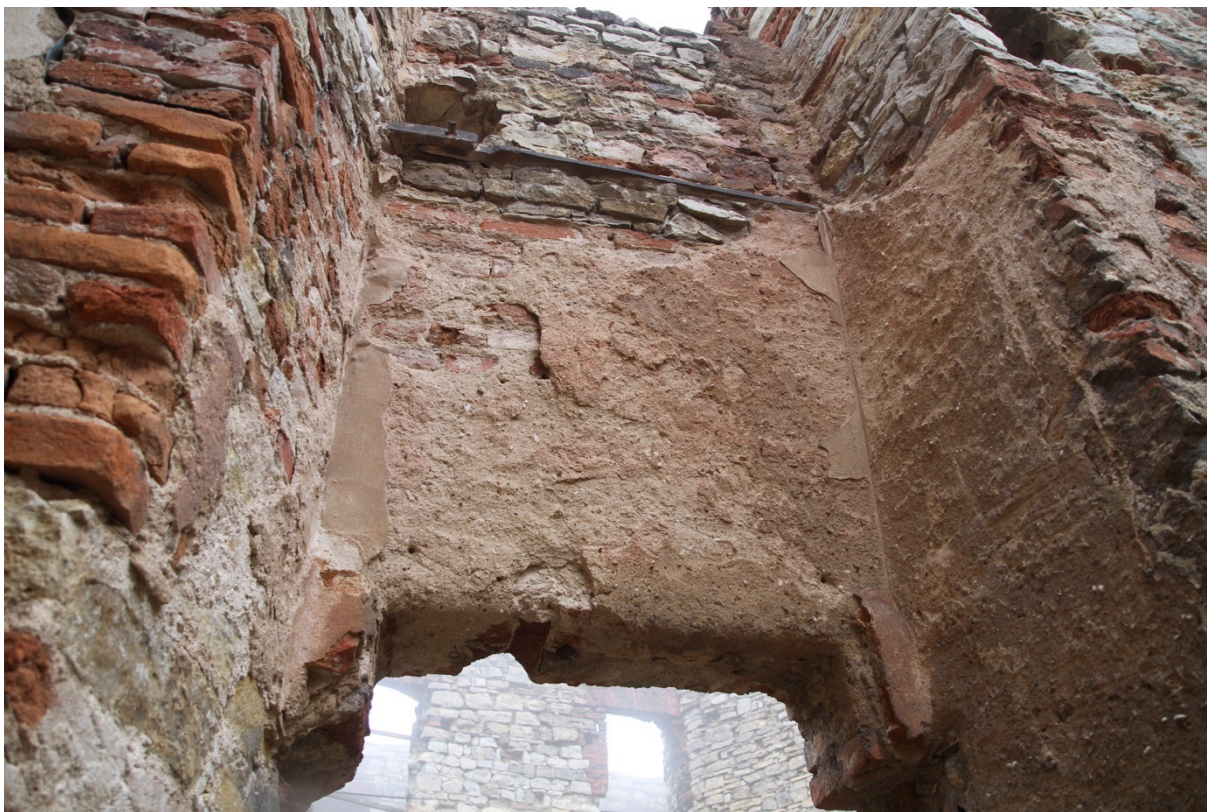
Fot. 34. Zamek w Lipowcu, ściana kaplicy zamkowej. Stan zachowania tynków.
