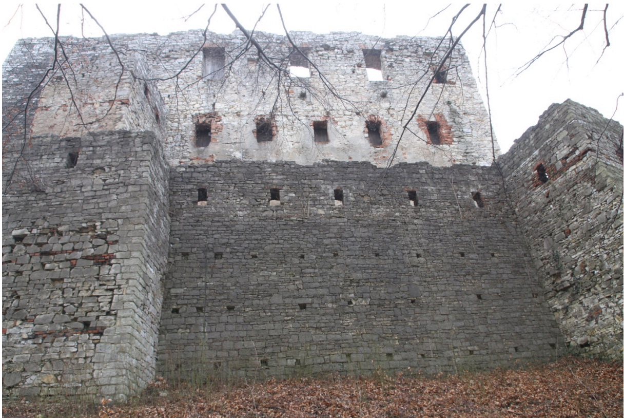
Fot.17. Zamek Lipowiec. Elewacja zamku górnego. Widoczne przemurowanie dolnej kondygnacji.
