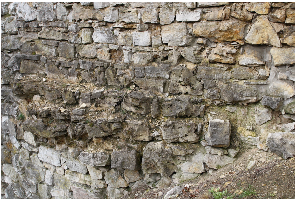
Fot.20. Zamek Lipowiec. Elewacja zamku górnego. Stan zachowania wątków murów obronnych.
