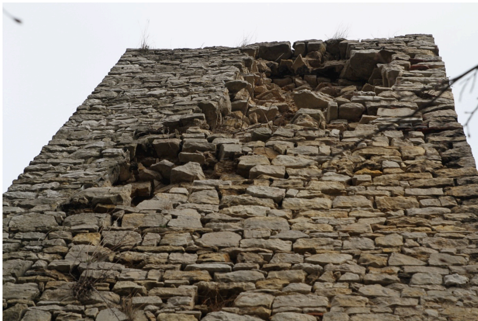
il.13. Elewacja zachodnia, stan zachowania wátku kamiennego.
