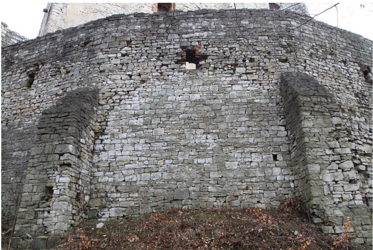
Fot.18. Zamek Lipowiec. Elewacja zamku górnego. Stan zachowania wątków murów obronnych.
