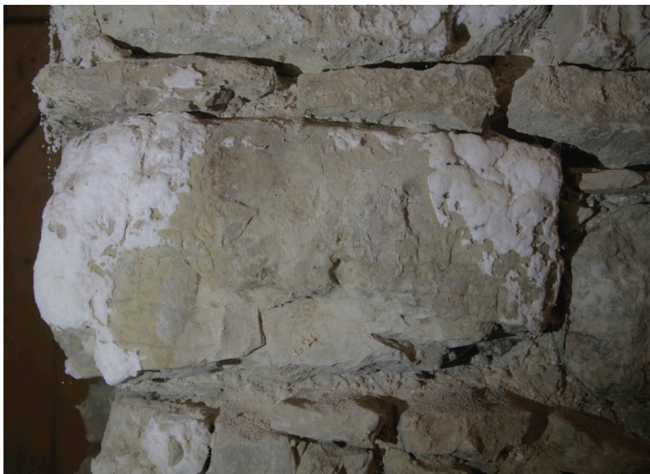
il.25. Kryształy soli mineralnych na wążku kamiennym, parter.
