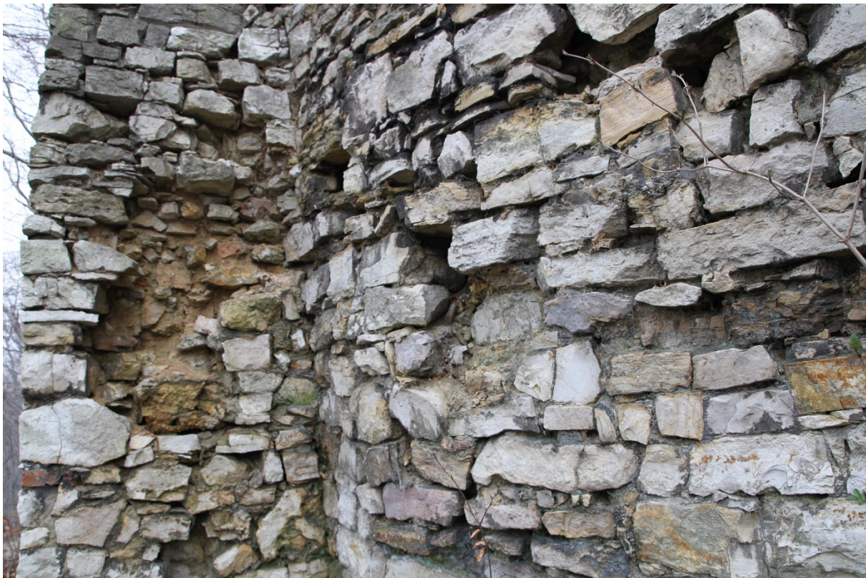
Fot.11. Zamek Lipowiec. Stan zachowania wątków kamiennych na murach obronnych.
