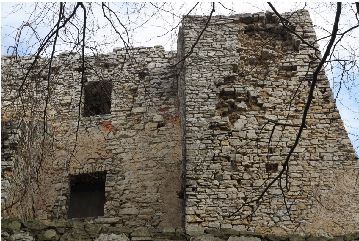
Fot.5. Zamek Lipowiec. Na zdjęciu duży ubytek muru na elewacji wschodniej zamku.
