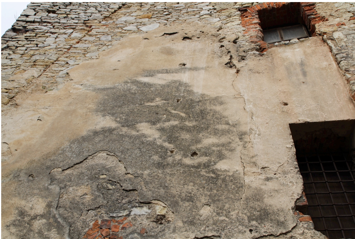
Fot.7. Zamek Lipowiec, elewacja południowa. Stan zachowania tynków na elewacji zamku.
