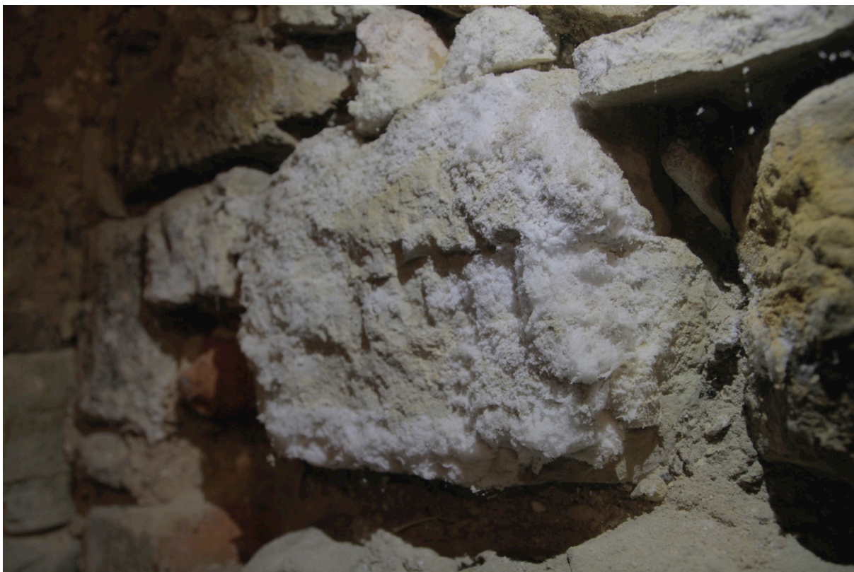
Fot.25. Zamek w Lipowcu, parter. Widoczna krystalizacja soli na wątku.
