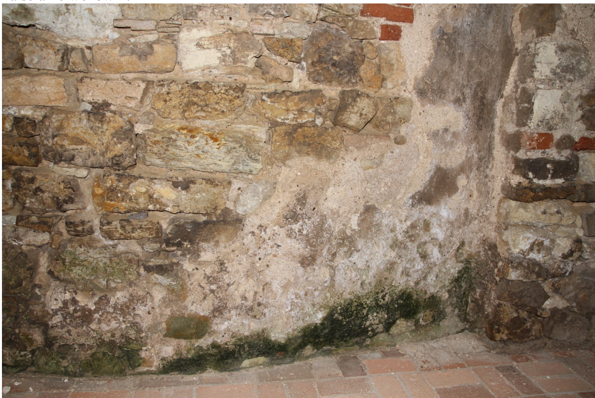
Fot.24. Zamek w Lipowcu, parter, sionka. Widoczne wysolenia, glony i porosty.
