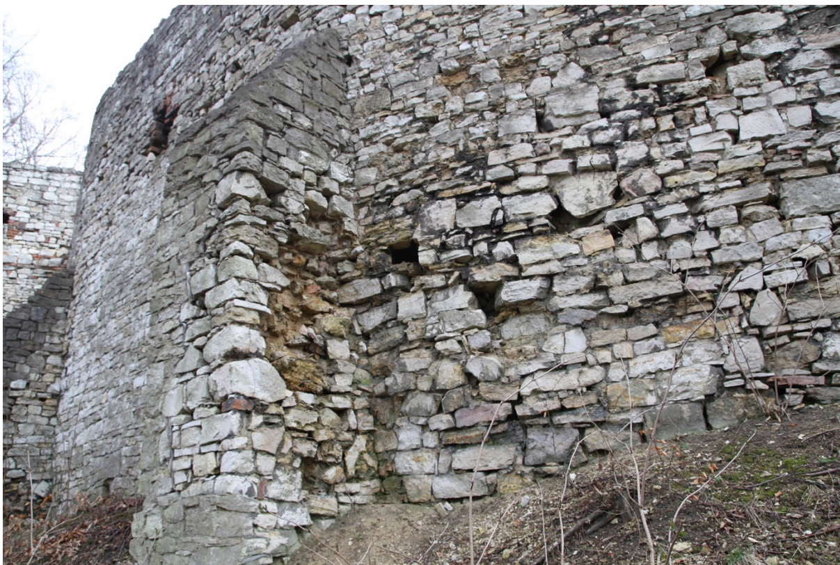
Fot.19. Zamek Lipowiec. Elewacja zamku górnego. Stan zachowania wątków murów obronnych.
