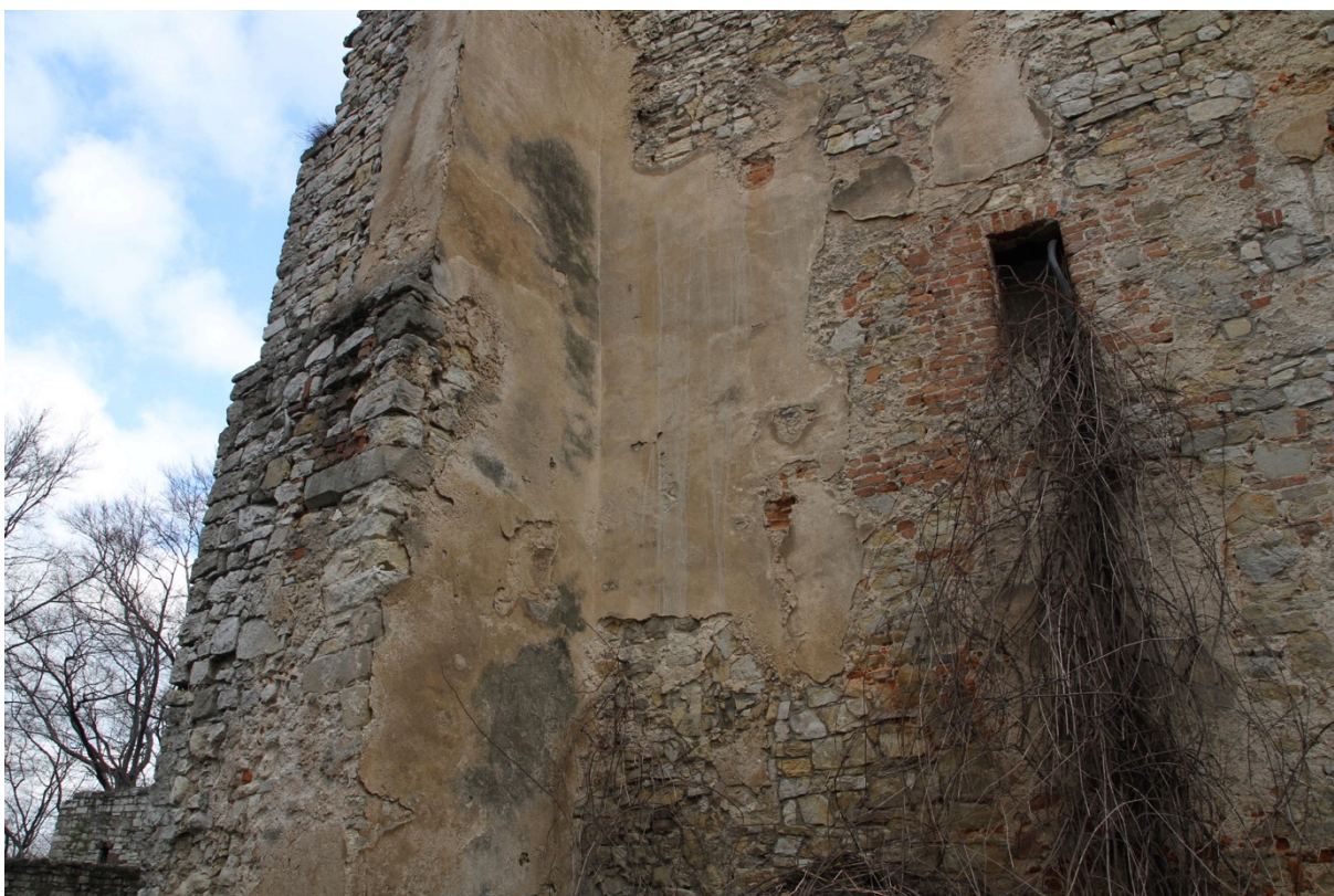
Fot.8. Zamek Lipowiec. Stan zachowania tynków na elewacji zamku.
