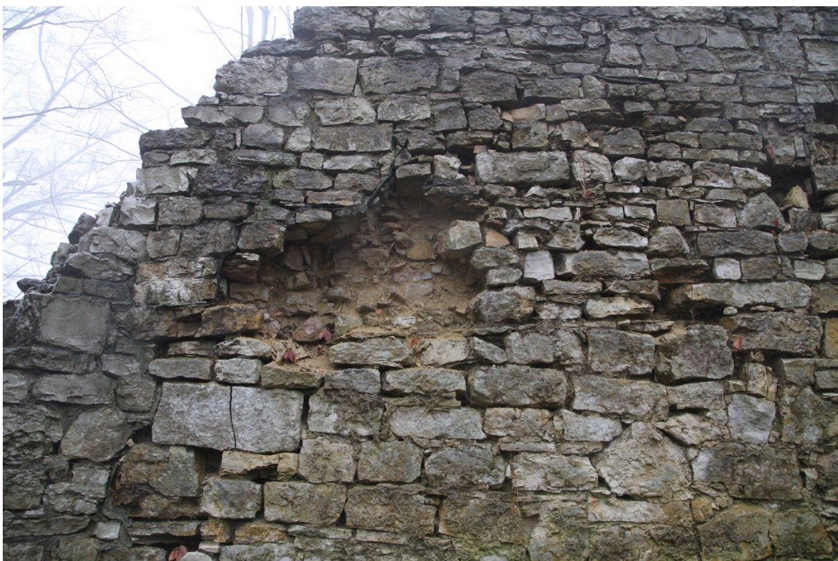
Fot. 16. Zamek Lipowiec. Stan zachowania wątków kamiennych na murach obronnych.
