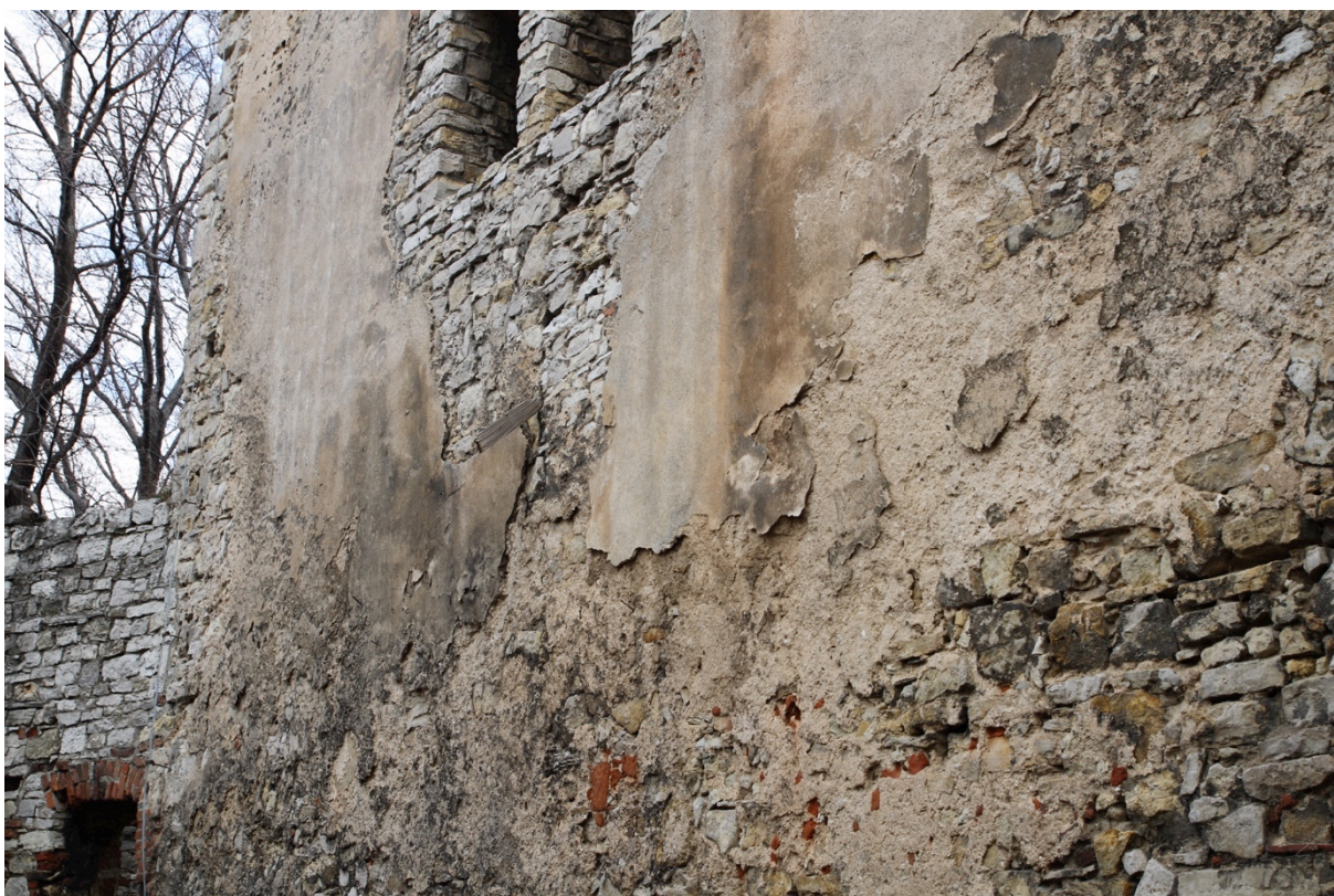
Fot.6. Zamek Lipowiec. Stan zachowania tynków na elewacji zamku.
