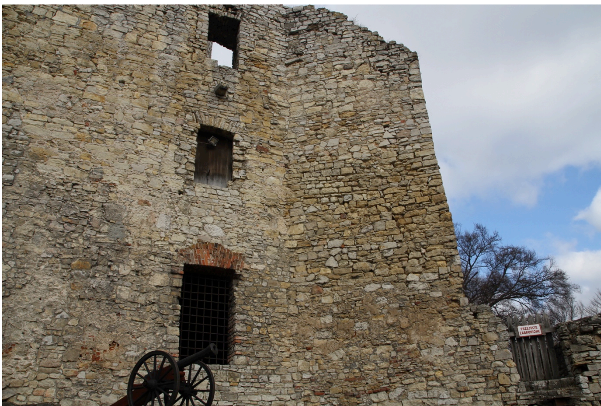
Fot.4. Zamek Lipowiec, fragment elewacji południowej. Na zdjęciu zły stan zachowania przypory.
