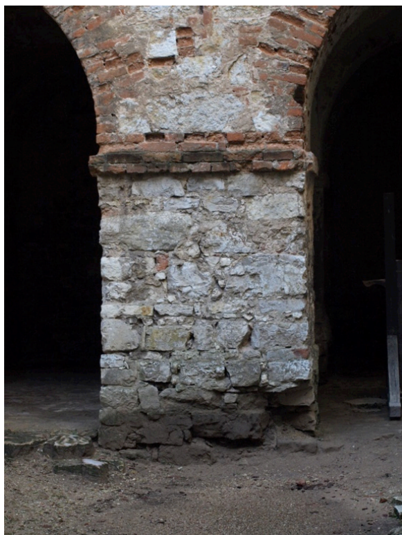
il.21. Stan zachowania filaru na północnej ścianie dziedzińca.
