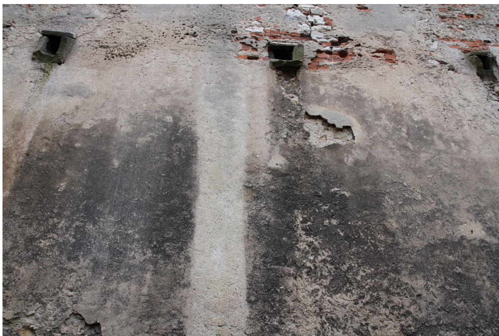
il.16. Elewacja północna, stan zachowania wypraw tynkarskich.
