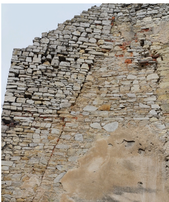
il.11 Pęknięcie na styku muru ze szkarpą na elewacji pld.
