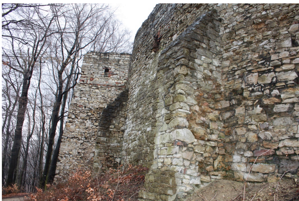
il.22. Mury obronne, widoczny duży ubytek wątku w dolnej partii przypory.
