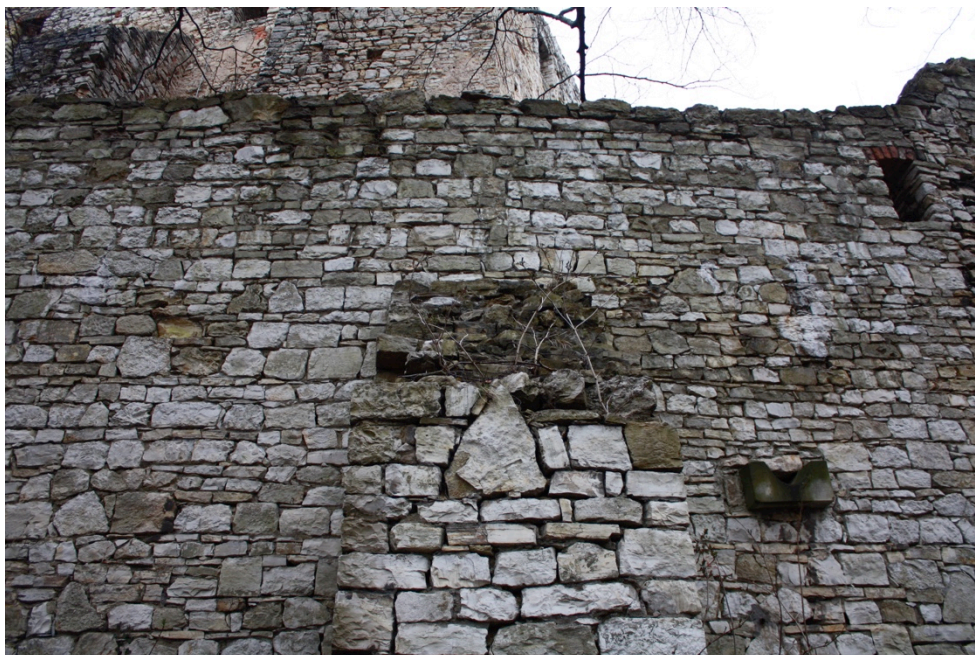
il.23. Mury obronne, rozluźniony watek kamienny przypory. Widoczne samosiejki drzew.
