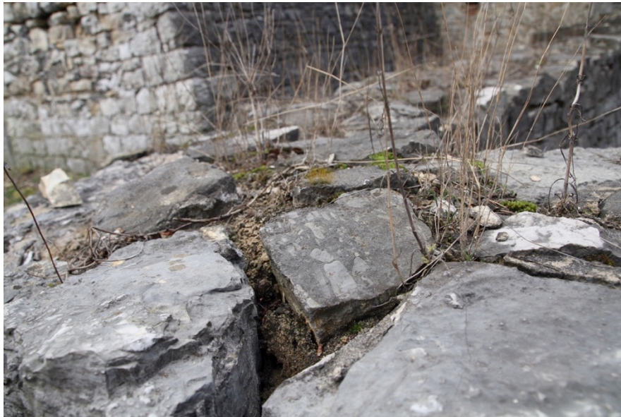
il.9. Ubytki spoinowania w koronach murów.
